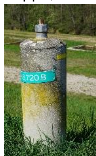
Piézomètre (protégé) sur la berge du canal.
